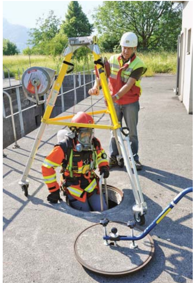
Beim Einstieg in einen Schacht wird die arbeitende Person durch eine zusätzliche Person überwacht.
